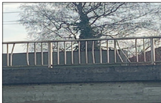
Provisorisch gesichertes Brückengeländer bei der Überführung Bernstrasse.
