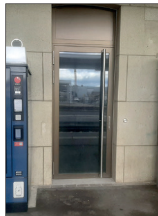
Aus einem technischen Grund ist der Wartsaal im Buchser Bahnhof nicht zugänglich. Die Reisenden mussten den ganzen Winter über an der Kälte warten. (Bild hwh)
